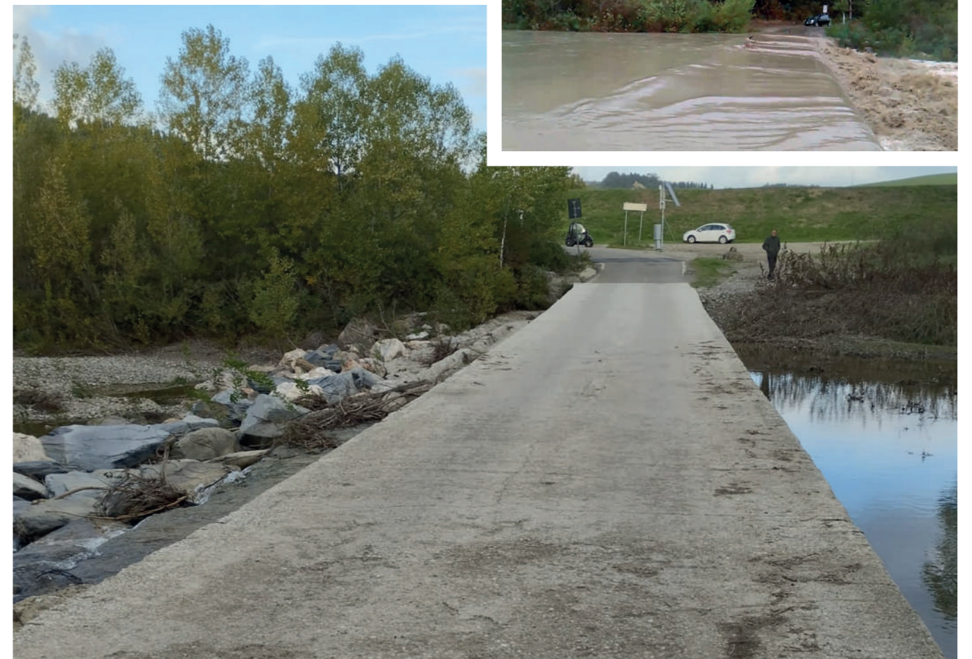
Sopra la passerella in località Ripassaia sul fiume Era e, nella foto in alto, una piena del torrente
