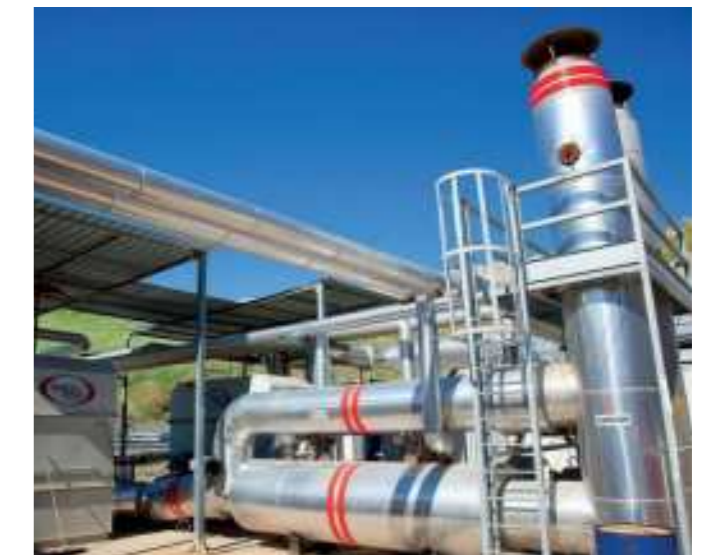
I motori di cogenerazione dell'impianto di trattamento e smaltimento rifiuti di Legoli
